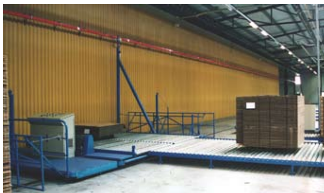
Railkoker type RN7 voor de voeding en besturing van een traversewagen in een kartonnagefabriek.
