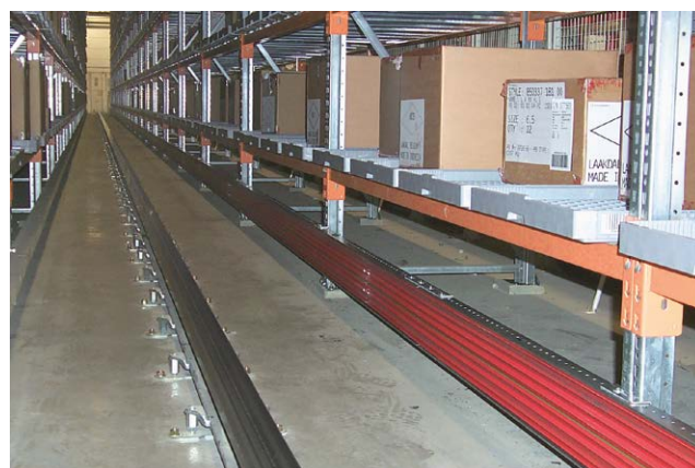
Installatie voor magazijnkraan met hoge rijnsnelheden
